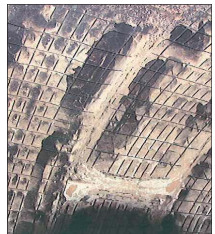
Photo 2 - Les pertes d'épaisseur du revêtement varient avec la densité des armatures.
